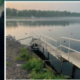
Неудовлетворительное состояние причала
