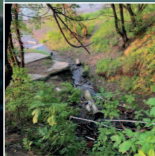
Переход через слив сточных вод
