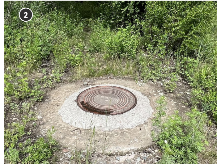
Канализационные люки на территории
